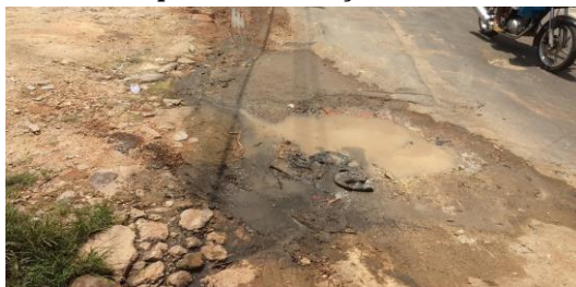
Figura 16. Afundamento por consolidação.
