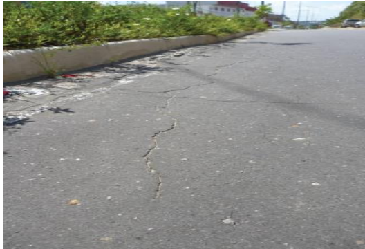
Figura 2. Trinca longitudinal longa
