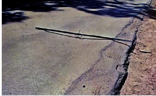
Figura 5. Afundamento de Trilha de Roda
