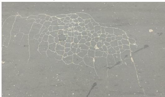
Figura 21. Trinca couro de jacaré.
