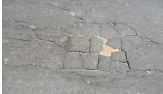
Figura 4. Trinca tipo bloco
