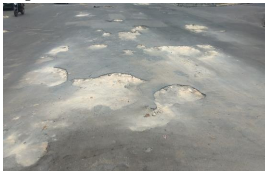
Figura 15. Patologia Painel ou buraco
