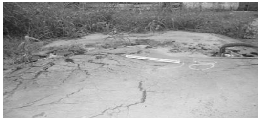
Figura 6. Afundamento de consolidação local
