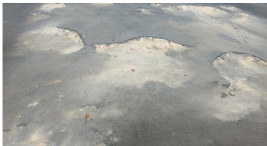
Figura 19. PANELAS OU BURACOS
