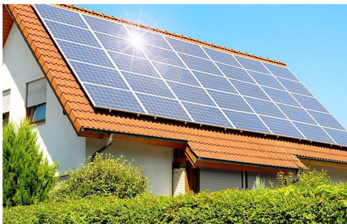
Figura 3: Pannel solar (composto de vários módulos solares) instalado em um telhado inclinado.
