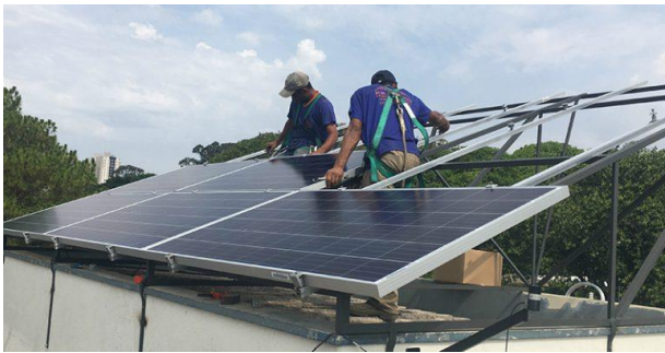
Figura 9: Suporte metálico para acomodação dos módulos solares.
