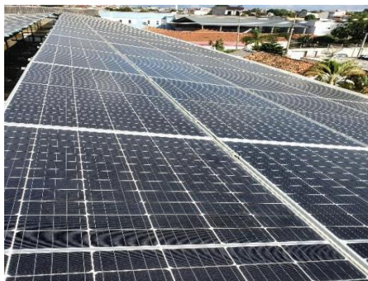
Figura 2. Módulos fotovoltaicos instalados
