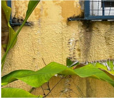
Figura 24 –Destacamento da pintura na fachada posterior do bloco H
