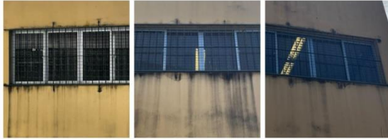
Figura 21 – Sujidade nas janelas da fachada posterior do bloco H
