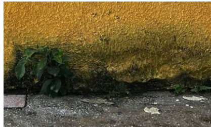
Figura 3 – Vegetação no piso da fachada frontal do bloco H
