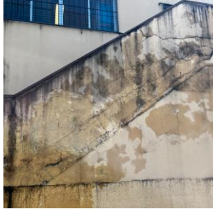
Figura 26 – Fissura diagonal na fachada posterior do bloco H
