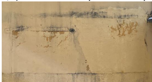
Figura 23 – Fissura, sujidade e destacamento da pintura na fachada posterior do bloco H
