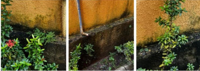
Figura 10 – Vegetação, mofo e bolor presentes na fachada lateral direita do bloco H
