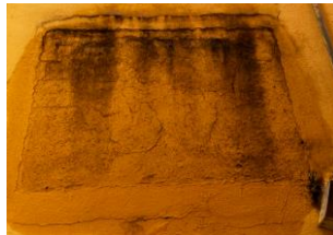
Figura 14 – Fissura aleatória na fachada lateral direita do bloco H
