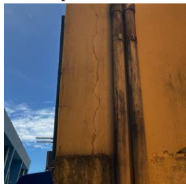
Figura 12 – Fissura vertical no pilar da fachada lateral direita do bloco H
