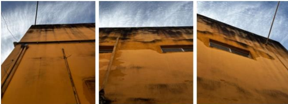
Figura 11 – Sujidade na parte superior da fachada lateral direita do bloco H
