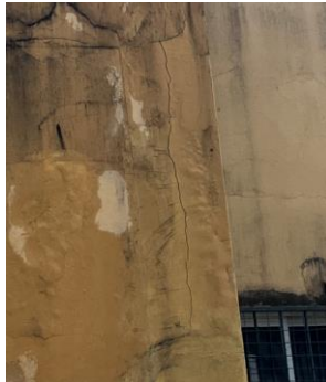
Figura 28 – Fissura vertical e bolhas no pilar da fachada posterior do bloco H
