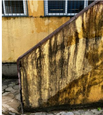
Figura 22 – Sujidade na parte externa da escada da fachada posterior do bloco H
