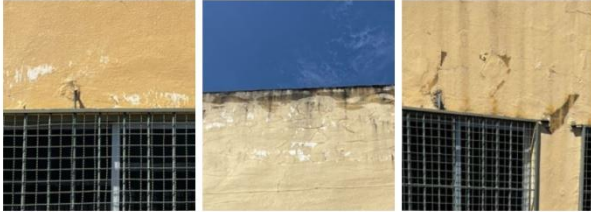
Figura 4 – Descolamento da pintura da fachada frontal do bloco H
