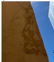
Figura 15 – Fissura sem direção definida na fachada lateral direita do bloco H
