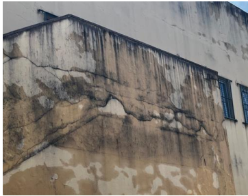
Figura 27 – Fissura horizontal na fachada posterior do bloco H
