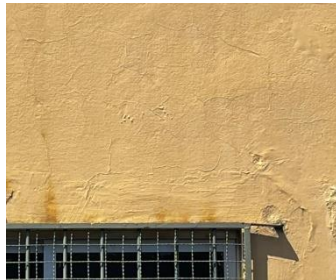
Figura 7 – Fissura mapeada na fachada frontal do bloco H
