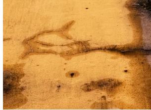
Figura 13 – Fissura aleatória na fachada lateral direita do bloco H
